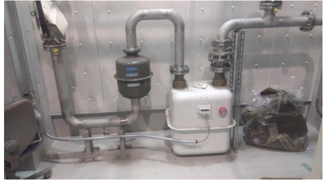
図5 ガスバッグ入口のオイルフィルター
