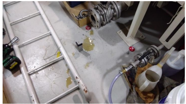
図8 ガスバッグ入口配管からの油漏れ
