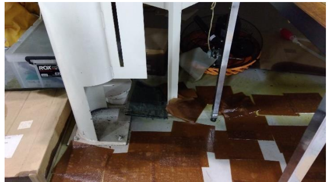
図 2 ヘリウム回収ガスバッグから油漏洩
