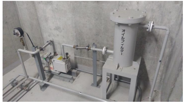
図4 サブステーションのポンプとオイルフィルター
