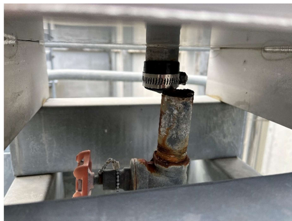
図4. 折損した膨張タンク下部配管
