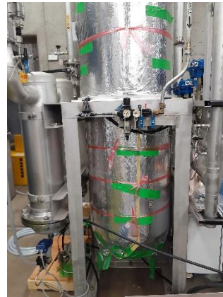
図 5. 断熱材で覆われた油分離器
