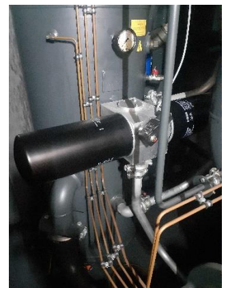
図 2. オイルフィルター オイルタンク横の黒い筒状のフィルター
