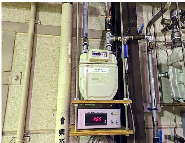
図6. 排出ラインに設置されたHeガス純度計
