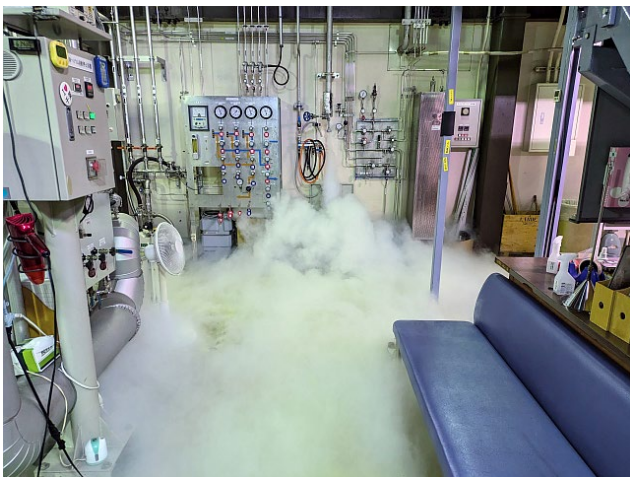
図3 液体窒素導入配管を予冷する様子
