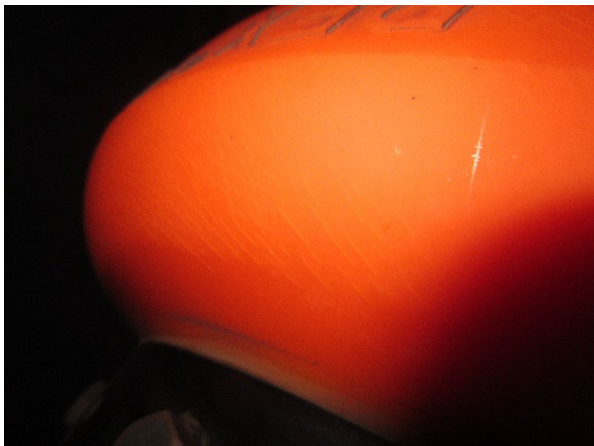
図6 カップリング劣化状況
