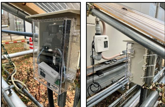
図3. 屋外設置の様子 図4. 屋外設置の様子2
