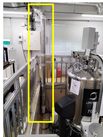
図6 ピット内換気ダクト
