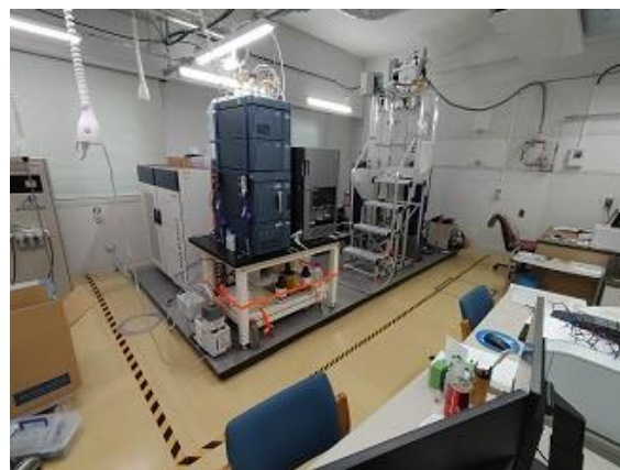
図2 免震台上に設置された装置類
