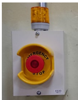
図 4 非常停止ボタンと回転灯
