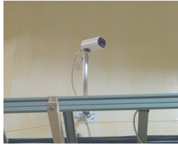
図 2 加速器室内に設置したカメラ
