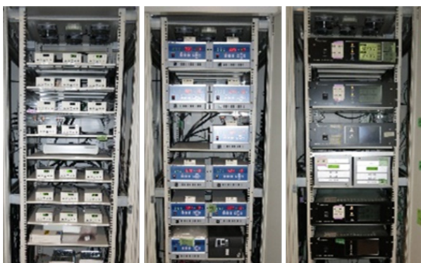
図 4: 電源棟ラック内コントローラ群.
