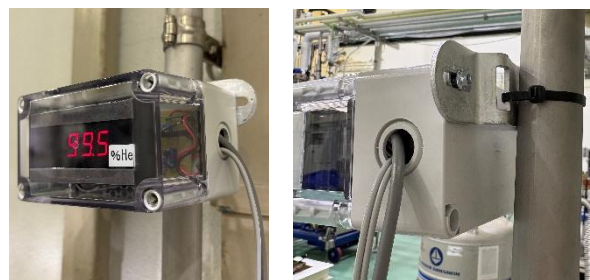
図 8 専用部品で配管に設置可能
