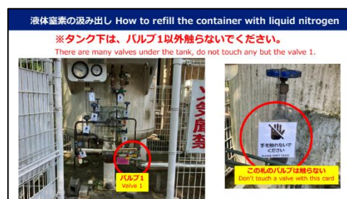
図 1. 操作バルブの注意喚起
