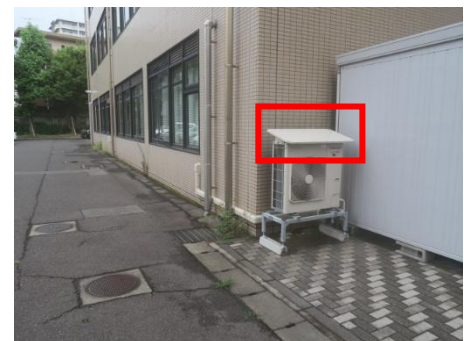
図 5.屋外に設置された室外機
