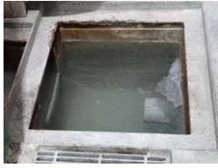
図4 排水柵Bからの排水不能
